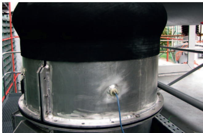
› Teploměr MI3 na plášti zapouzdřeného vodiče
